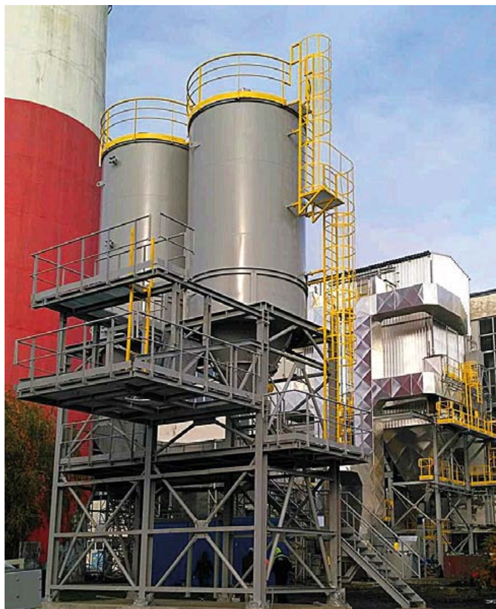
Widoczne na zdjęciu silosy do części systemu odsiarczania. Magazynowane w nich wapno hydratyzowane będzie wiązało związki siarki, oczyszczając spaliny.
